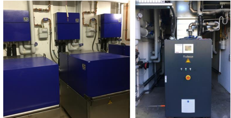
Blockheizkraftwerke des Unternehmens
